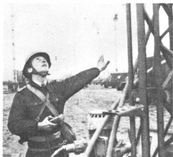
Bild 3 Millimeterarbeit und Fingerspitzengefühl des Truppführers Stabsfeldwebel Bernd Staschkeit sind gefragt, wenn der 30 m hohe Stahlgittermast genau senkrecht ausgerichtet wird
